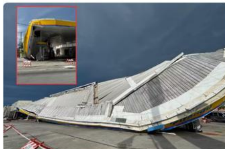
Ventania derruba estrutura de posto de combustíveis em Praia Grande, SP — Foto: Matheus Croce/TV Tribuna
