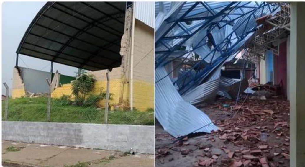
A escola sofreu destelhamento, além da queda de muros em Itapeva (SP) — Foto: Defesa Civil/Divulgação
