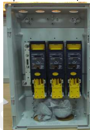
Quadro para um circuito (I202000)
